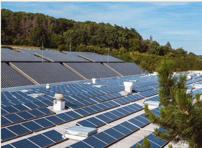
Champ solaire à proximité du centre commercial
