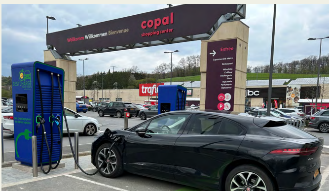
Borne de recharge électrique sur le parking
